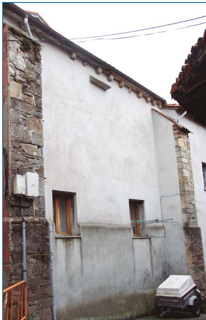
Restos de la fachada del Hospital
